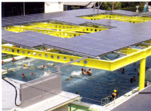
プール上空に40kWの太陽光パネルを設置 (高知県香南市立野市小学校)
