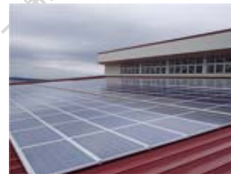
鹿野中学校体育館 Middle School Gym (59.8kW)
