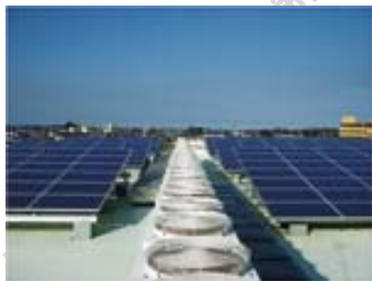
市役所第二庁舎 City Hall (69KW)
